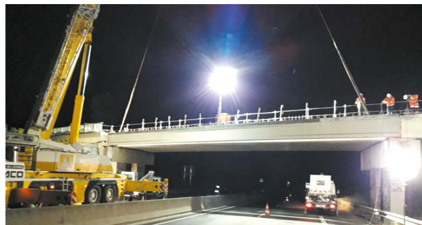
Mise en place de la poutre préfabriquée à l'usine Matière au moyen d'une grue de 200 T
