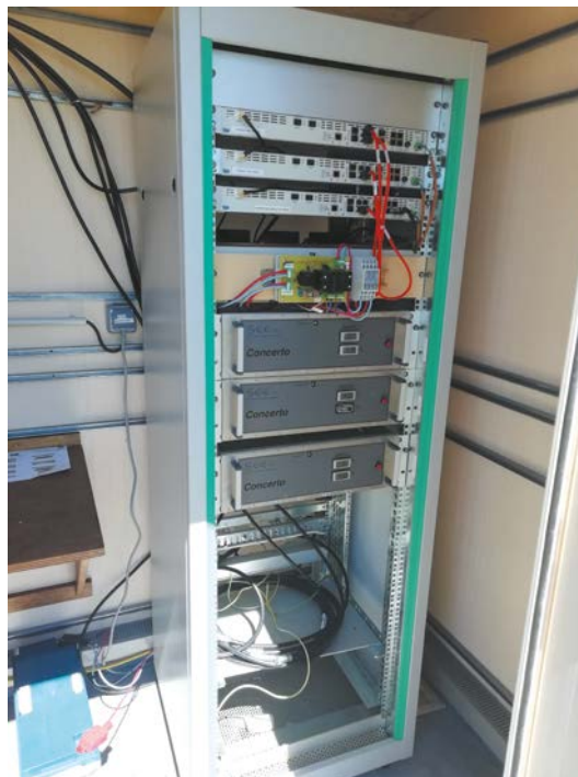
Baie radio du local technique de La Pépinière
