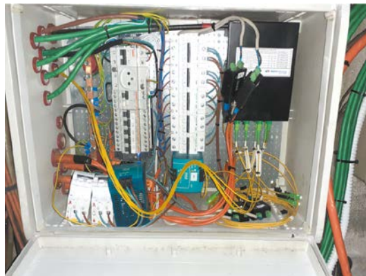
Ancien coffret de raccordement
