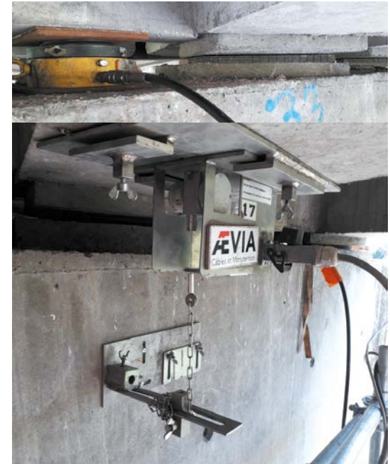
Vérins et système de contrôle pour levage de l'ouvrage → réparation des bossages et changement des appareils d'appuis
