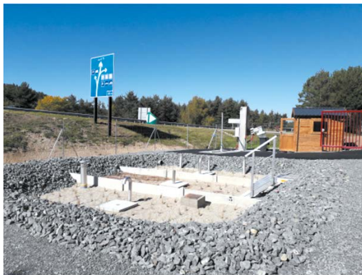
Aire Est Sens 2 Filtre planté de roseaux (45 m 2 )
